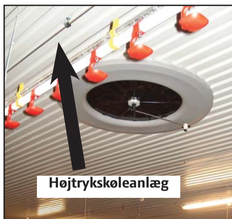
Billede 1: Højtrykskøleanlæg som en del af brandsikkerheden hos Vinni og Povl Larsen.
